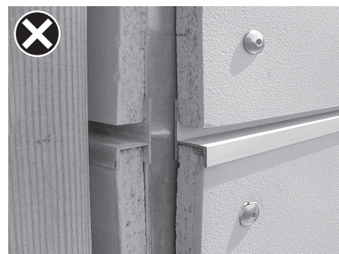
Nevyrovnaný podklad pod deskami
